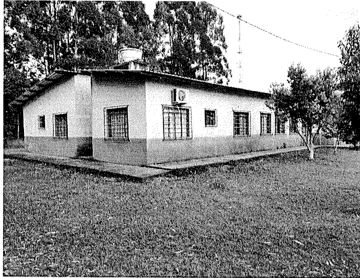
Fotografia 02 – Fundos, pintura deteriorada e janelas antigas.
